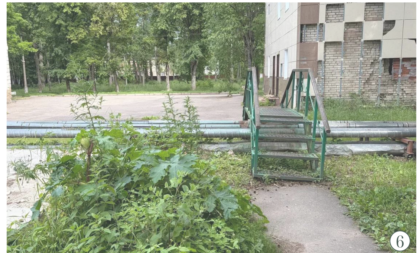
ТРЕБУЕТСЯ РЕМОНТ ПЕРЕХОДОВ ЧЕРЕЗ БАЙПАСС
