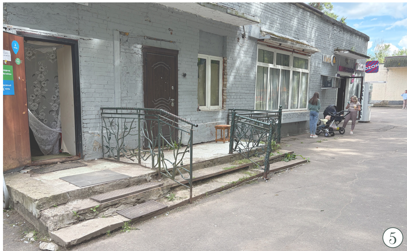
ТРЕБУЕТСЯ БЛАГОУСТРОЙСТВО ПРИЛЕГАЮЩИХ ЗОН
