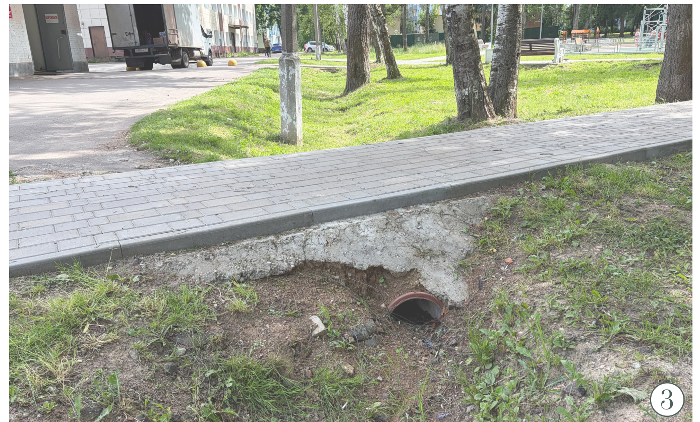
ТРЕБУЕТСЯ БЛАГОУСТРОЙСТВО ВОДООТВОДНЫХ ЭЛЕМЕНТОВ
